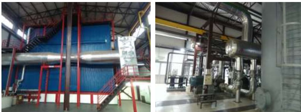
Слика 3. Изглед котла (лево) и пумпног постројења (десно)
